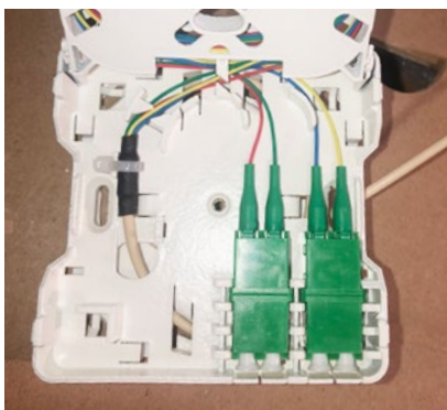
Sonderkonfiguration gemäß den Vorgaben des geförderten Glasfaserausbaus
