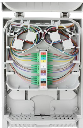
MDU-XL-Wallbox Patchbereich mit beispielhafter Konfektionierung
